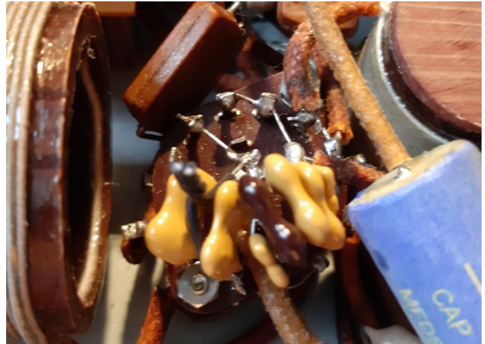
De condensatoren van de bandspreiding. Let op de in elkaar gedraaide stukjes montagedraad voor het in de band brengen van de 40m bandspreiding,
